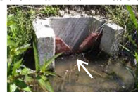
水位調整板を設置した排水樹
