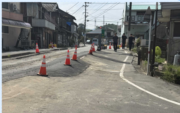
【被害を受けた道路・建物(小川町)】
