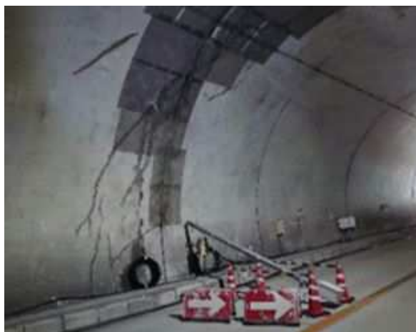
【トンネル内部の剥離状況】
