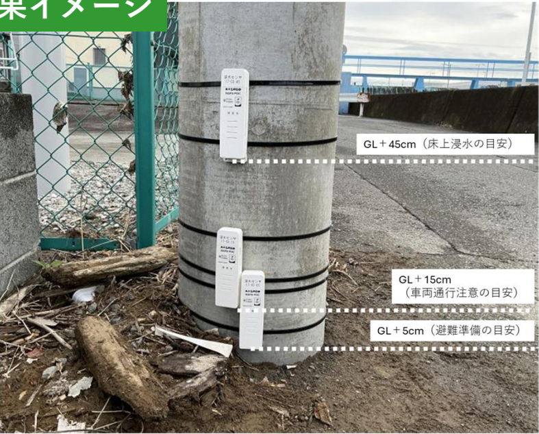
浸水センサーの設置状況（清水区江尻台町）
