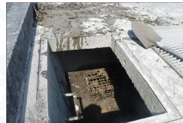
貯留施設内の堆積土砂
