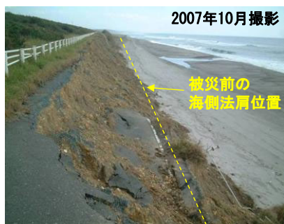
2007年7月の台風4号による 堤防上自転車道の被災状況
