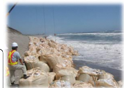
写真 新居海岸の侵食状況（2002（H14）年）
