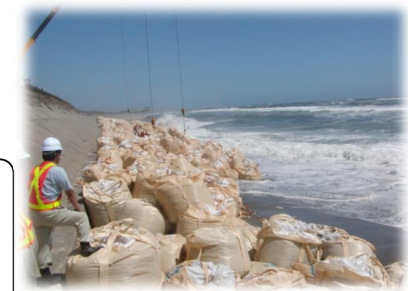
写真 新居海岸の侵食状況（2002（H14）年）
