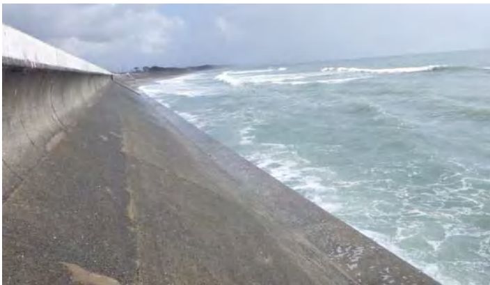
相良片浜海岸の南側は砂浜が消失した状態 2020年9月8日撮影
