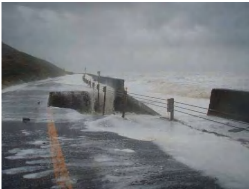
2009年台風18号による海岸護岸と県道の被災 (2009年10月8日撮影)
