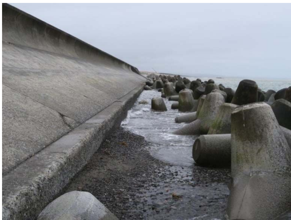
基礎の露出した竜洋海岸の堤防（2018年5月8日）
