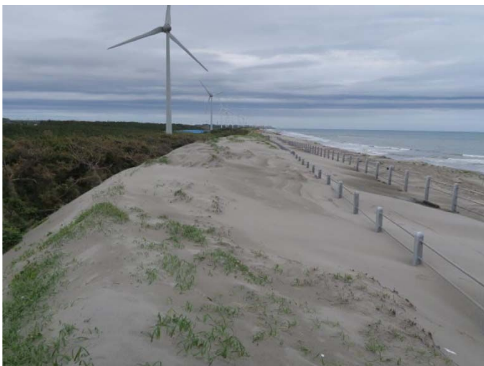
自転車道を越えて陸側に大量に堆積した飛砂（その1）（2018年5月9日）
