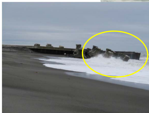
突堤左右の消波ブロックは、既に洗掘により沈下。突堤も早急に対策が必要。
