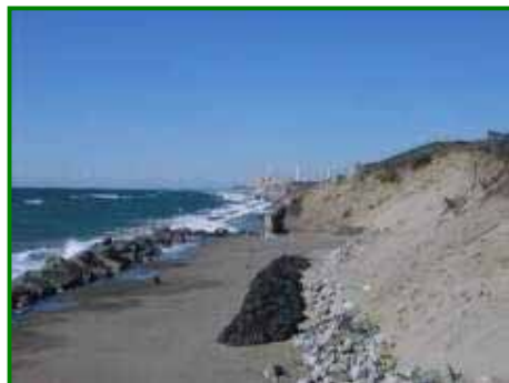
侵食による護岸崩壊
