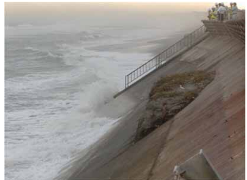
2002年 新居海岸の侵食によるBP基部露出
