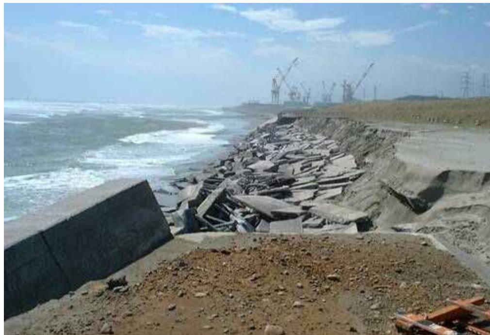
2005年 御前崎海岸の堤防崩壊
