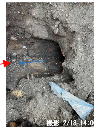
横断排水管の状況（腐食）
