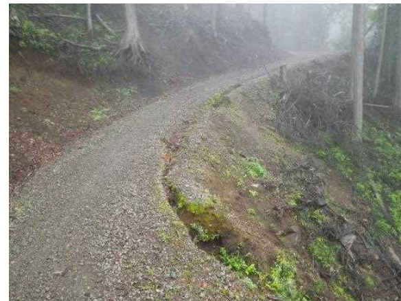
写真の撮影年月：2017年6月 写真の説明：法面の崩れ（生土地区）
