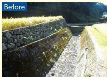
集落排水施設
