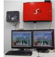
(環境制御装置)
