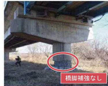
【橋梁耐震対策の重要性】
