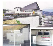
非常用電源設備や大型モニターなどを設置
