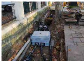
電力線が直接埋設された例（ロンドン）
