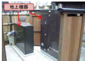
民地を活用した地上機器の設置
