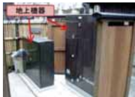
民地を活用した地上機器の設置
