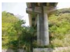
橋脚の補強が必要な 国道136号深田大橋 （西伊豆町宇久須）
