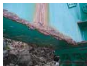
損傷が激しい 国道136号天狗橋 （南伊豆町子浦）
