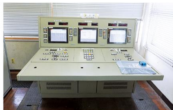
操作卓(ゲートの開閉などを行う)
