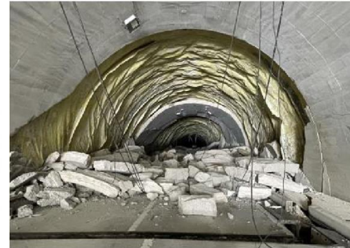
覆工コンクリート崩落
