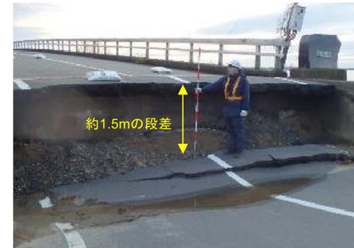
橋台背面段差 約1.5mの段差
