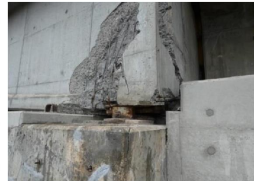
橋梁被災(桁端・支承)
