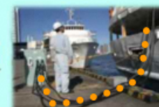
電力供給設備
