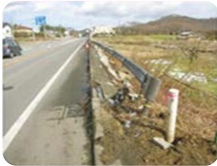
ガードレール・ 標識等の損傷
