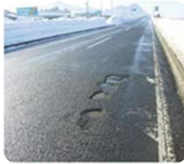
路面の穴ぼこ・ 段差
