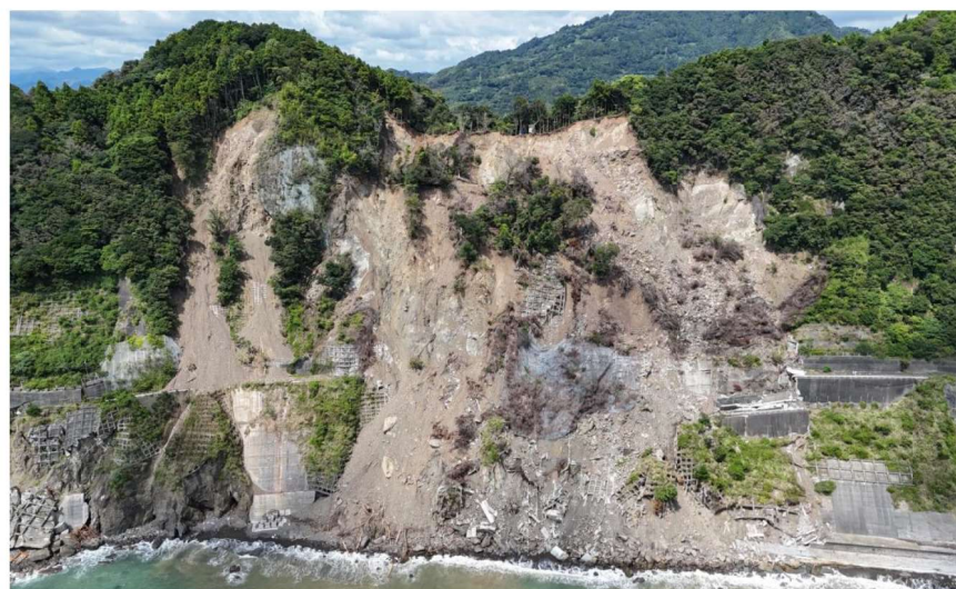
斜面崩壊全景（R6.9.4撮影）
