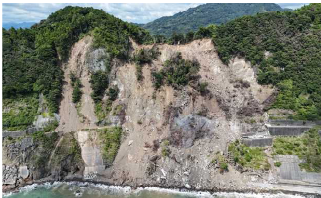
斜面崩壊全景 （R6.9.4撮影）
