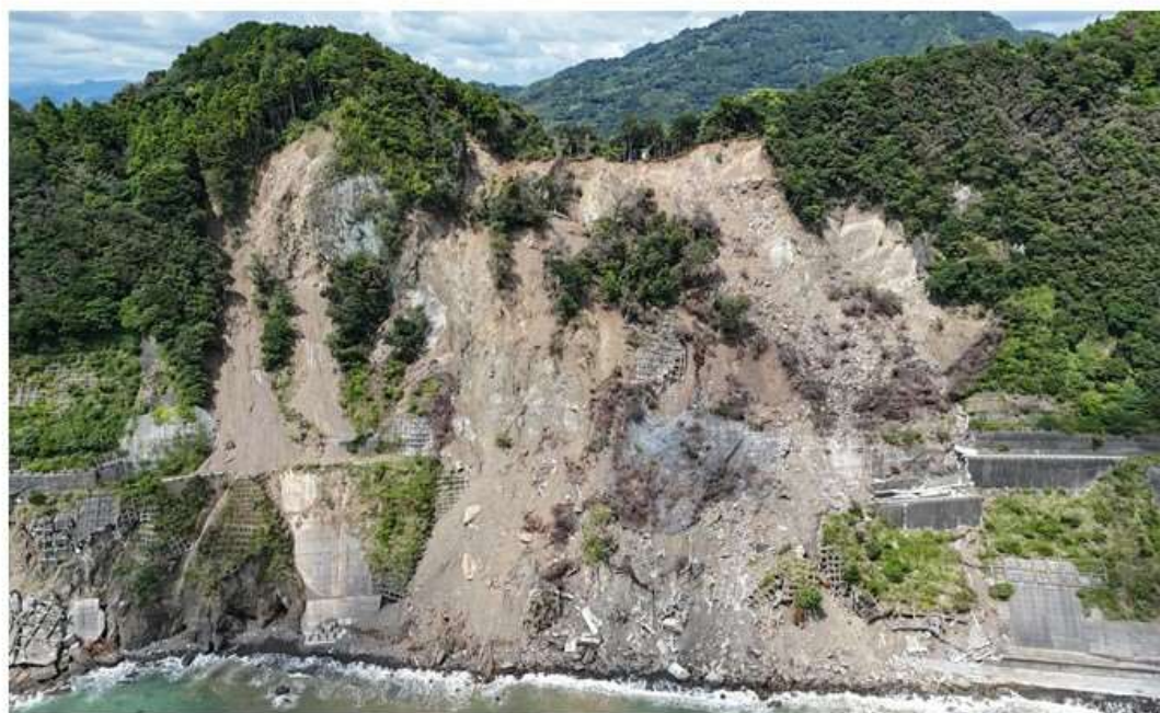
斜面崩壊全景（R6.9.4撮影）
