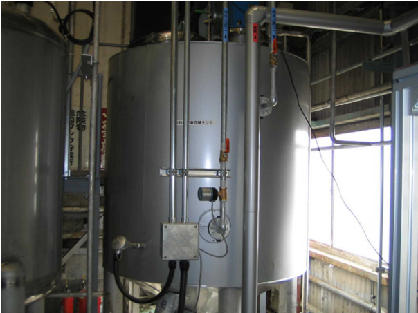
▲ 写真1 原料の糖化兼発酵槽
