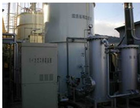
写真 プラントの概観
