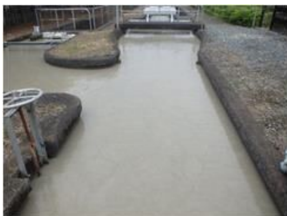
三方原用水 18号分水工の濁水状況
