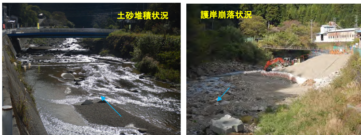
図 4-7 中河内川の現状（R5.11撮影） （河岸侵食・のり面崩壊の状況 災害復旧工事中）
