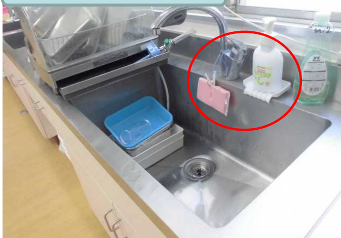
スポンジの管理（良い例）
