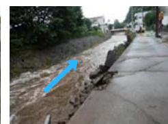
柳沢地区 高橋川の護岸の欠損 ※災害復旧工事を実施予定
