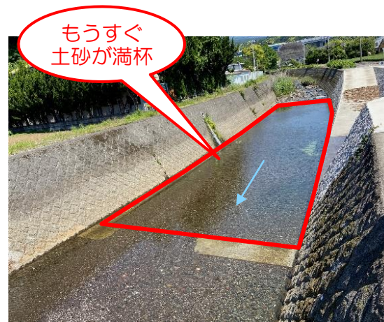
完成2か月後の土砂堆積状況
