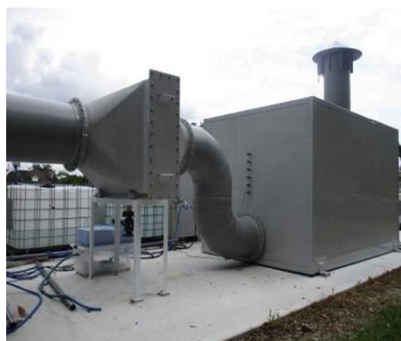
図2 脱臭資材を利用した吸着脱臭装置
