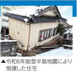
▲令和6年能登半島地震により倒壊した住宅
