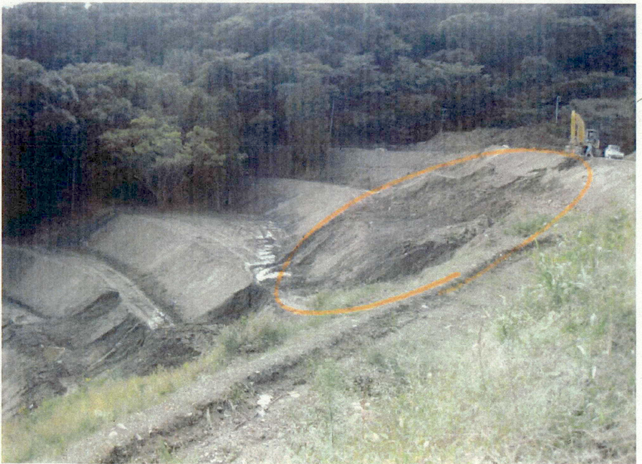
雨により法面が崩落してゐる
