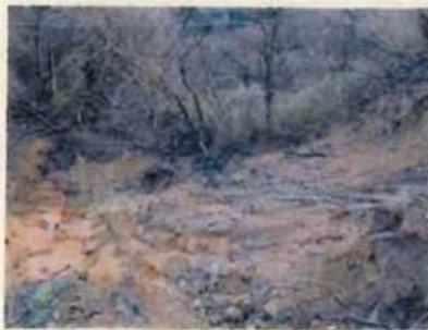
⑮ 雨水流出部
