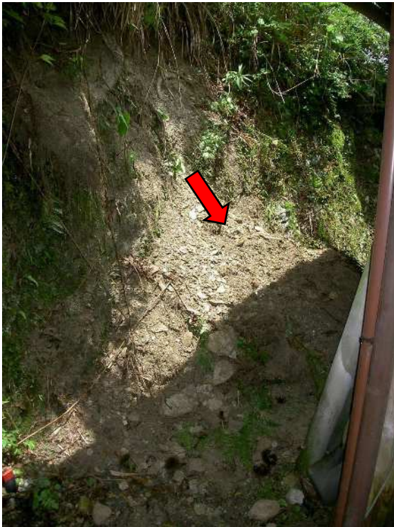
B区域の崩壊状況
