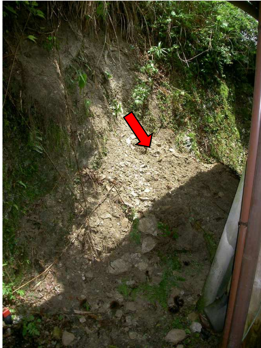
B区域の崩壊状況
