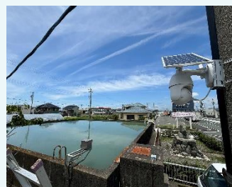
遠隔監視システム
