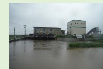
排水機場（毘沙門2期地区）
