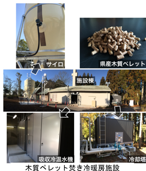
木質ペレット焚き冷暖房施設
