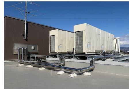
屋上（空調室外機）
