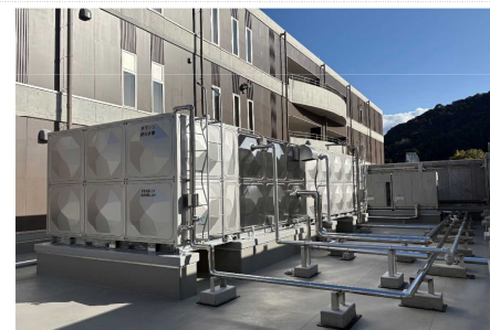
3階屋上（受水槽・消火設備）
