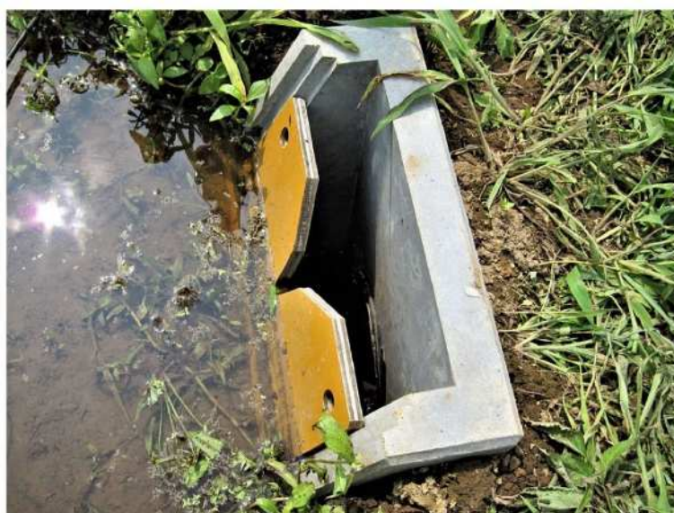
設置されたコンクリート製田んぼダム対応落水枡 p2
