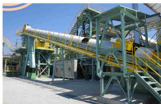
洗浄処理施設
