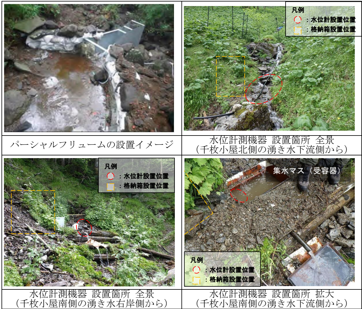
図 17 地表面付近の湧き水モニタリング (1/2)
