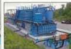
写真 湧水処理設備の例
