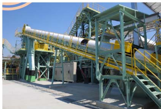
洗浄処理施設
